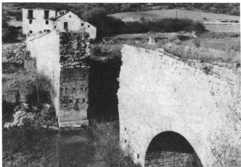
Lám. I. PUENTE DE FANLO. Sobre el río Gállego. Su voladura durante la guerra civil (1936-39) permite observar el relleno de cascote y el cridado aparejo externo; en el intradós del arco central son visibles los mechinales para la cimbra. Es citado en el S. XIV, dando nombre a una circunscripción administrativa: el Justiciado de Puente de Fanlo. Actualmente ha sido reconstruido.
