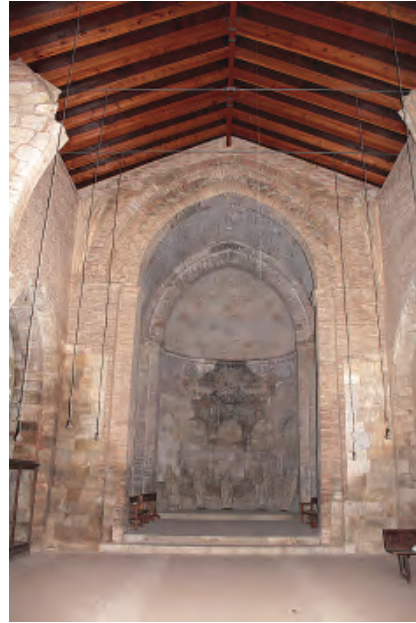
Fig. 16. Iglesia de San Juan. Estado actual. Vista del interior del templo con la cubierta construida en la intervención de 1981. Foto de la autora.
