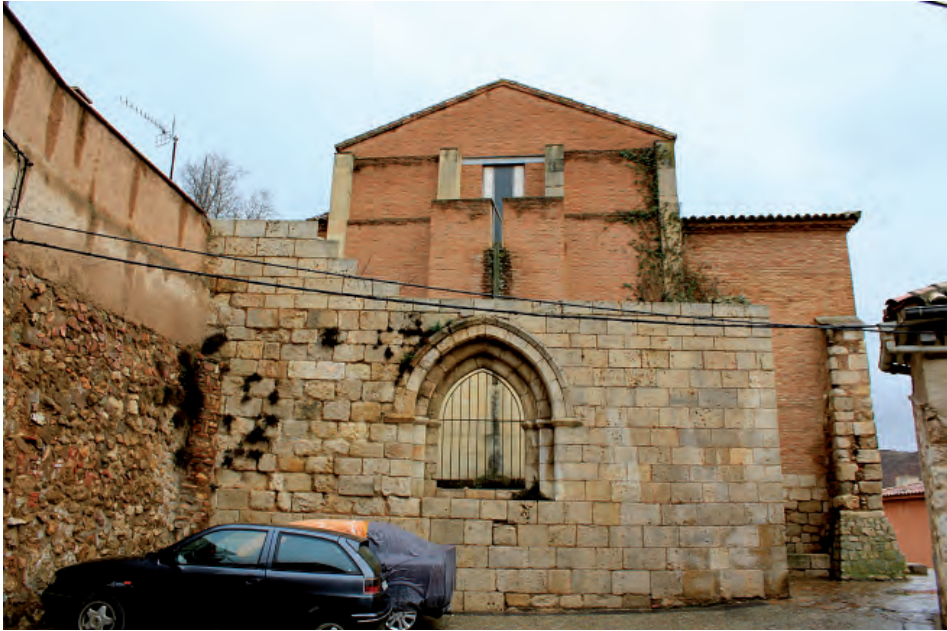
Fig. 18. Iglesia de San Juan. Estado actual. Vista del testero del templo desde el exterior con el muro construido en la intervención de 1981. Foto de la autora.
