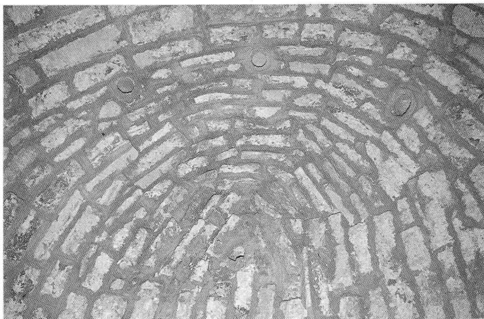
Fig. 7. San Fructuoso de Barós. Anforas de resonancia o acústicas en la bóveda absidal.
