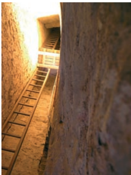
Fig. 17. Caja de escaleras. Escalera de madera repuesta que llega hasta un rellano intermedio que no existía originariamente y desde el que mediante otra escalera se llega hasta el primer rellano intermedio del siglo X cuyo suelo no se conserva.
