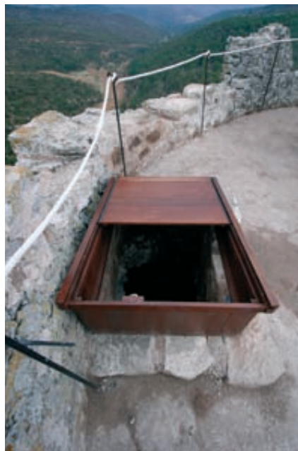
Fig. 20. Acceso original a la terraza (visto hacia el sur) que ha sido protegido con una estructura lúnea a una vertiente.
