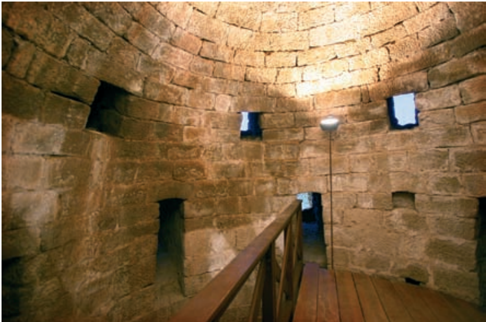
Fig. 16. Forjado de madera del nivel de cadalsos inferiores visto hacia el noroeste con los dos pequeños vanos cuadrados por los que se accede a los cadalsos superiores.
