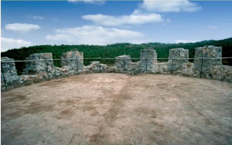
Fig. 21. Vista general de la terraza hacia el oeste con el cordón de señalización de peligro.
