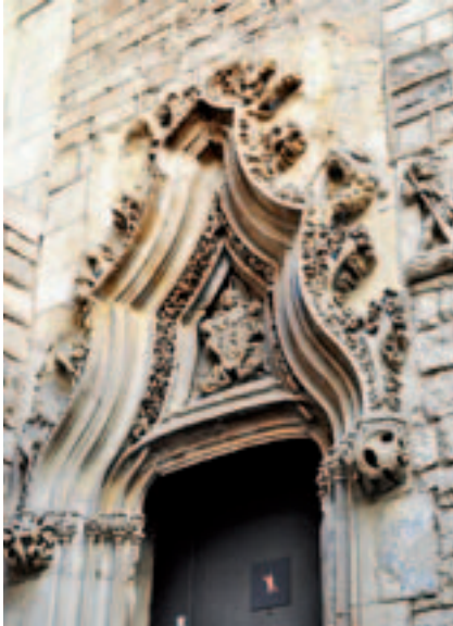
Fig. 34. Palacio Berenguer de Aguilar de Barcelona. Puerta de los estudios (finales del siglo XV).
