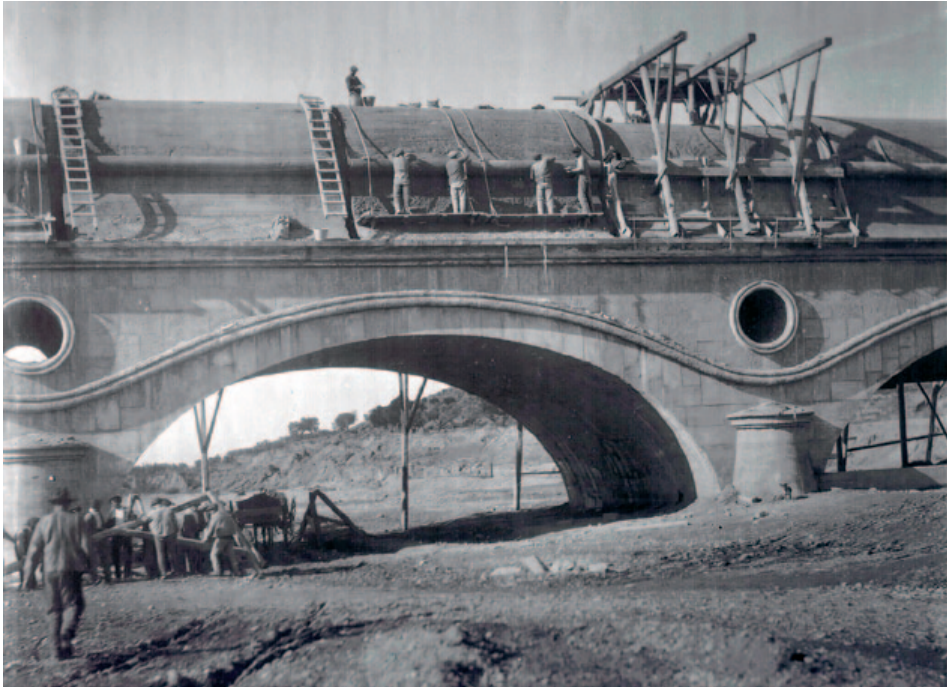
Fig. 16. Moldeo y enlucido de la envolvente sobre el puente Sosa, 1905. Archivo General de Palacio [AGP], nº 10.186.068.
