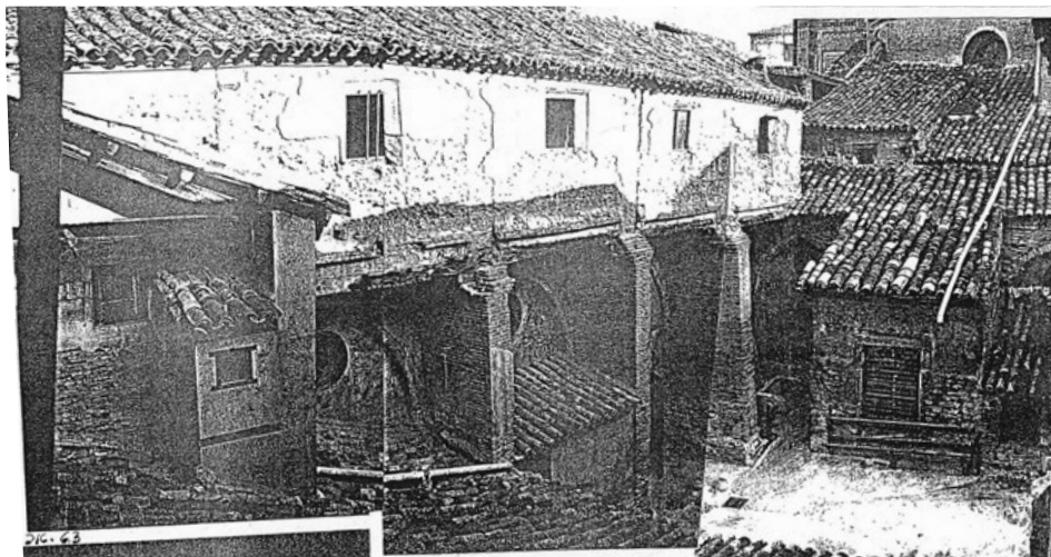
Fig. 2a. Estado del patio anterior a la intervención de Ramiro Moya Blanco. Fotografía de 1966. A.G.A.
