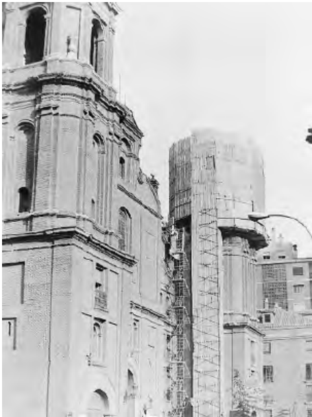
Fig. 16. Nueva vista del andamio de la torre de la Epístola. Gerardo Sancho (23-I-1980). A.M.Z.
