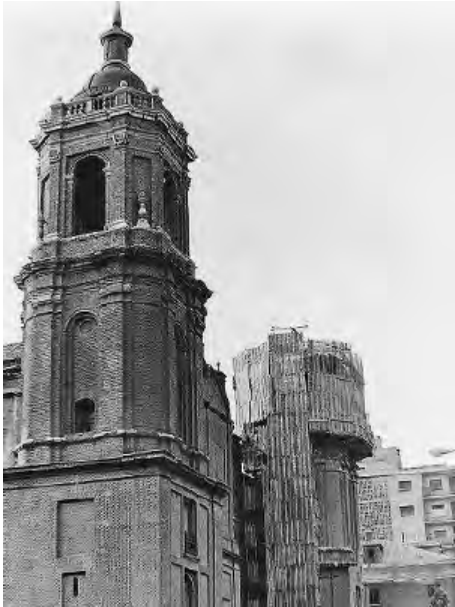
Fig. 14. Fachada principal del templo con el andamio ya montado en torno al cuerpo de la torre de la Epístola. Gerardo Sancho (septiembre 1979-enero 1980). A.M.Z.
