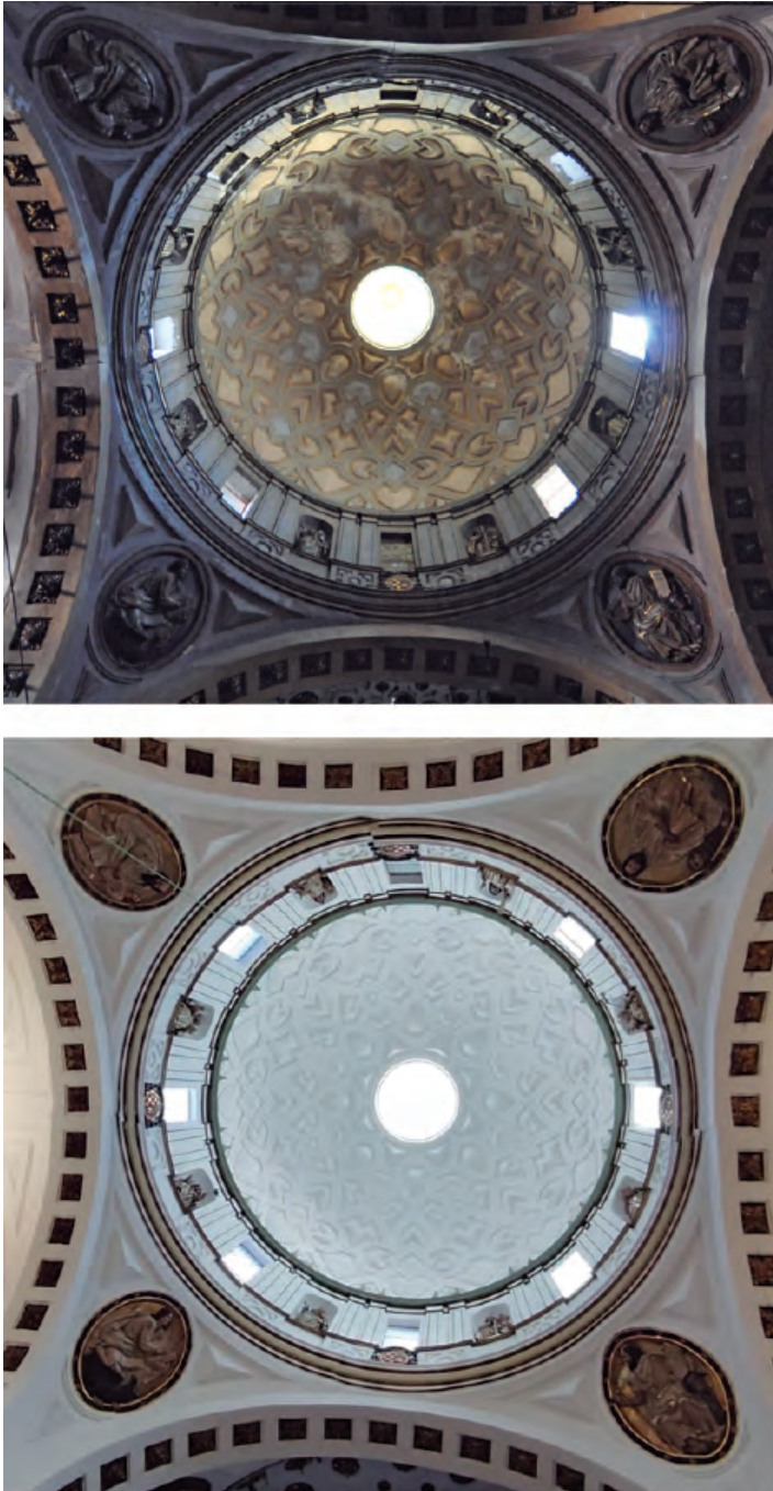
Fig. 6. Interior de la cúpula, antes y después de su restauración. Fotografías de 2010 y 2021 tomadas con luz natural.
