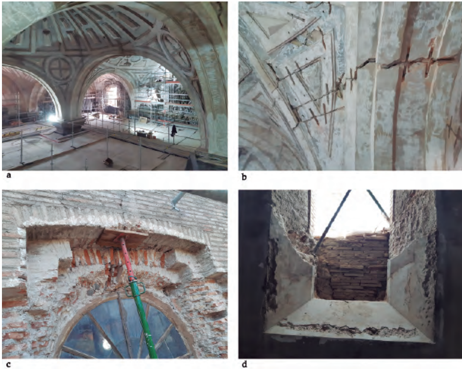
Fig. 8. Trabajos de reparación estructural realizados durante la restauración del interior, en 2021: a) Bóvedas de la nave central, durante su reparación estructural desde la plataforma de trabajo; b) Detalle de los cosidos estáticos realizados en las bóvedas; c) Recuperación del formato de los vanos originales, conservado bajo el tabicado, vista exterior; d) Recuperación del formato de los vanos originales, que habían sido tabicados para convertirlos en óculos, vista interior.
