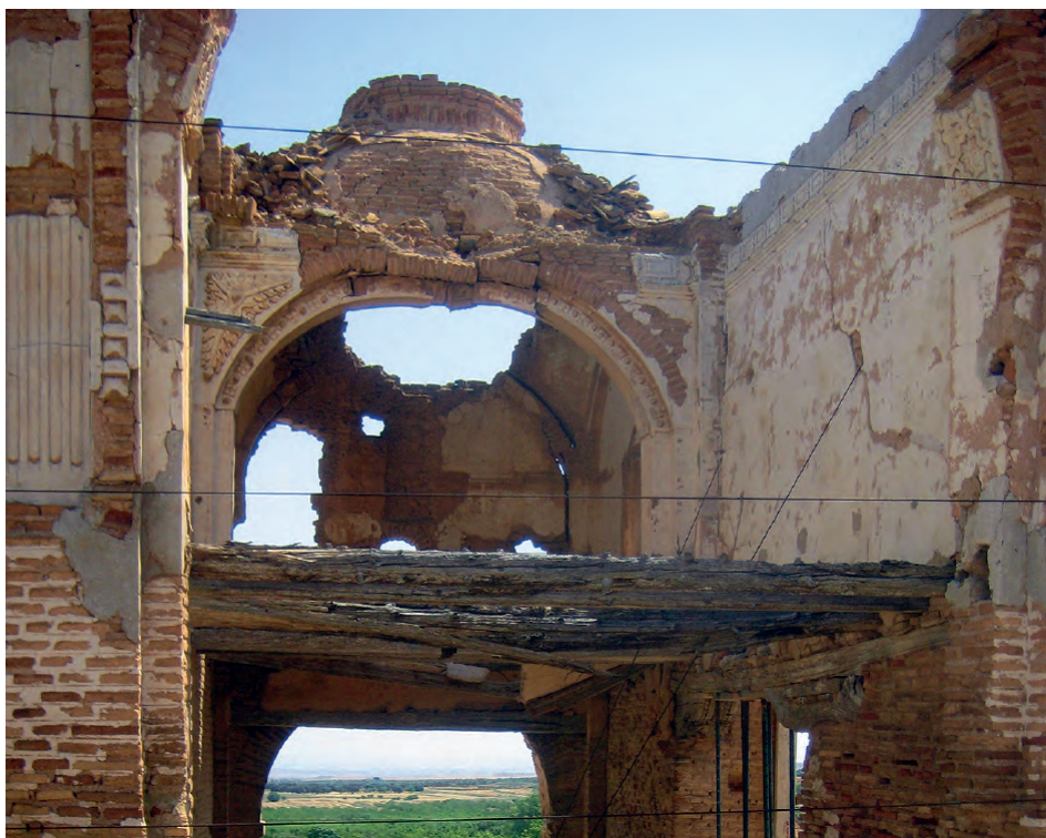
Fig. 3. Estado del Arco de San Roque antes de la intervención. Fotografía: J. Borobio Sanchiz, archivo BAU, exp. n° 200641.
