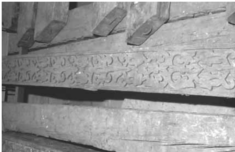
Fig. 9. Córdoba. Mezquita aljama. Techumbre de la ampliación de al-Hakam II. Viga perteneciente a una de las naves 2ª, 3ª, 4ª u 8ª contadas desde el Este con la zona central en la parte inferior de la fotografía.
