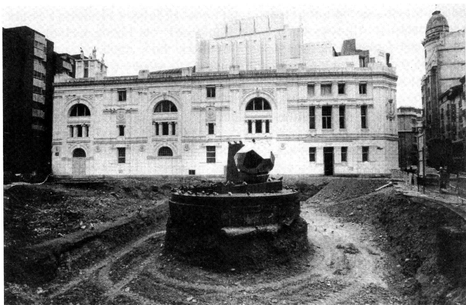
Fig. 11. Comienzo de las obras en la plaza José Simués. Vista de la fachada posterior y pabellón de escena, 1988.
