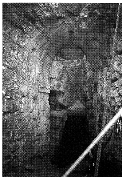
Fig. 20. Vallferosa. Castillo. Torre. Interior. Habitación de acceso a la terraza vista desde el este, apreciándose en el extremo izquierdo el paso al cadalso contiguo existente por el trasdós de la cúpula.
