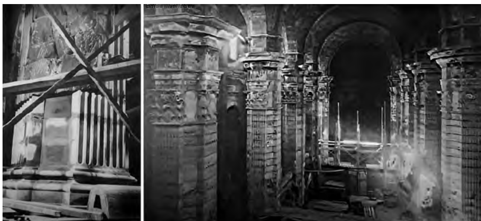
Fig. 8. Detalle del proceso de reconstrucción y aplacado de los pilares centrales de la Catedral de Lleida (Archivo Histórico de Lleida, Fondo Regiones Devastadas); Vista del estado en que quedó la nave central y sus pilastras en el momento en que se iniciaron los trabajos de rehabilitación (Archivo Capitular de Lleida).
