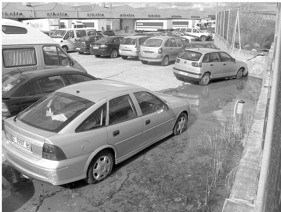
Figura 3. Presencia de fracturas en el suelo y las paredes del parking de una fábrica al oeste de la ciudad de Zaragoza. Fotografía realizada por Andreas Deckelman y Christian Tigler. Febrero 2006.
