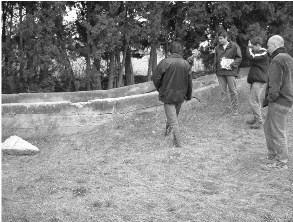
Figura 4. Ruptura en un pequeño canal en las proximidades de La Cartuja debido a la subsidencia del terreno. Marzo 2006.
