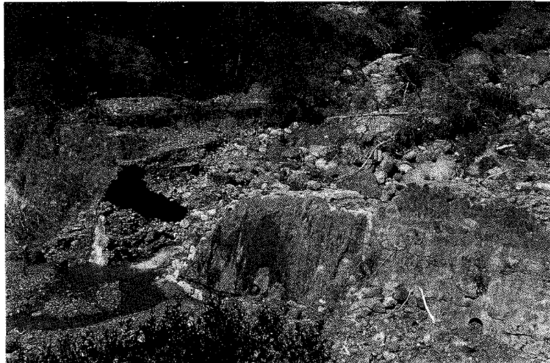
Fotografía 2.- Detalle de la destrucción de uno de los muros transversales de retención de sólidos y laminación de avenidas, en la parte alta de Arás.
