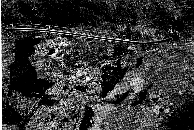
Fotografía 1.- Puente de Yosa, derruido por socavamiento basal de uno de sus pilares, que aparece tumbado en primer plano.
