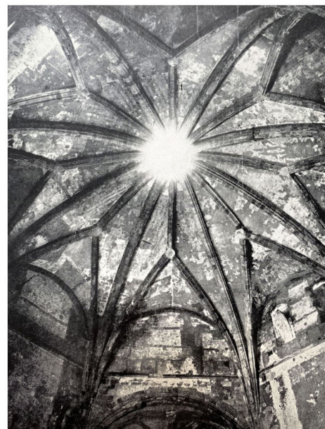
[12] NAPOLI, CASTEL NUOVO, GRAN SALA, INTRADOSSO DELLA COPERTURA DOPO L'INCENDIO DEL 1918, FOTO DELLA SOPRINTENDENZA D'ARTE MEDIOEVALE E MODERNA (R. FILANGIERI, CASTEL NUOVO , CIT., P. 69).
