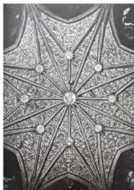
[17] NAPOLI, CASTEL NUOVO, CAPPELLA DI SAN FRANCESCO DI PADLA, RIVESTIMENTO INTRADOSSALE DELLA COPERTURA (R. FLANGERI, CASTEL NUOVO , OT., P. 175).
