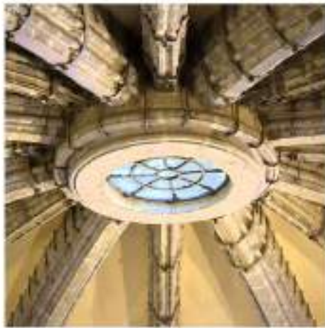
[13] NAPOLI, CASTEL NUOVO, GRAN SALA. PARTICOLARE DELL'INNESTO DI COSTOLONI E TIEBECON CON L'OCULO CENTRALE OGGI IN ANORE. IL MODELLO COSTRUTTIVO DELLA COPOLA DELLA GRAN SALA. CIT., P. 57).
