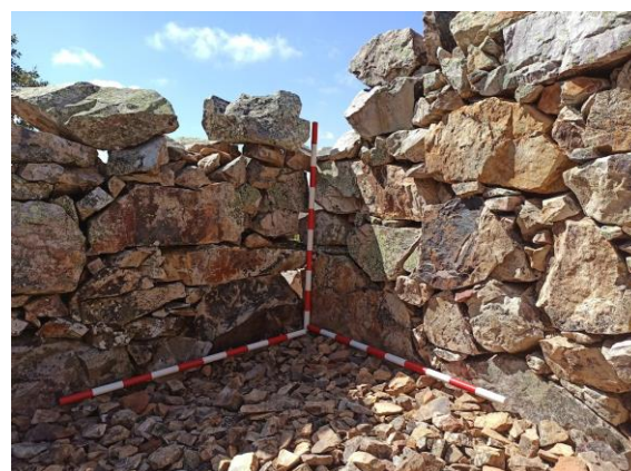
Figura 5. Detalle de los sistemas constructivos de las estancias interiores; Sup.: estructura N.º 4; Inf.: estructura N.º 7.
