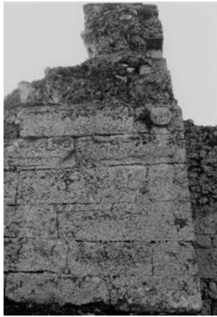
Lámina 32. Olèrdola: "Torre I" de la muralla de la fortaleza; detalle del aparejo de opus quadratum con almohadillado alisado de escaso relieve con listel perimetral. Obsérvese la presencia de un umbo o cilindro en relieve en uno de los bloques. La cronología de esta obra se localiza entre finales del siglo II y comienzos del I a.e.
