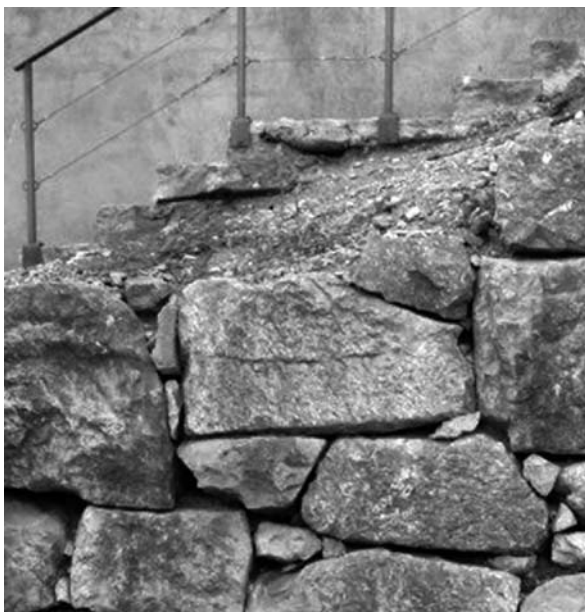
Lámina 15. Emporiae (Ampurias romana): sector Norte de la muralla oriental. Aparejo de opus siliceum que puede ser adscrito a la II manera, con bloques irregulares reuntados con cuñas y abundante ripio. La cronología de esta obra, por criterios estratigráficos, se localiza a principios del siglo I a.e.
