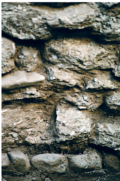
Fig. 6. Detalle de la irregularidad de la mampostería de esta cara del muro.
