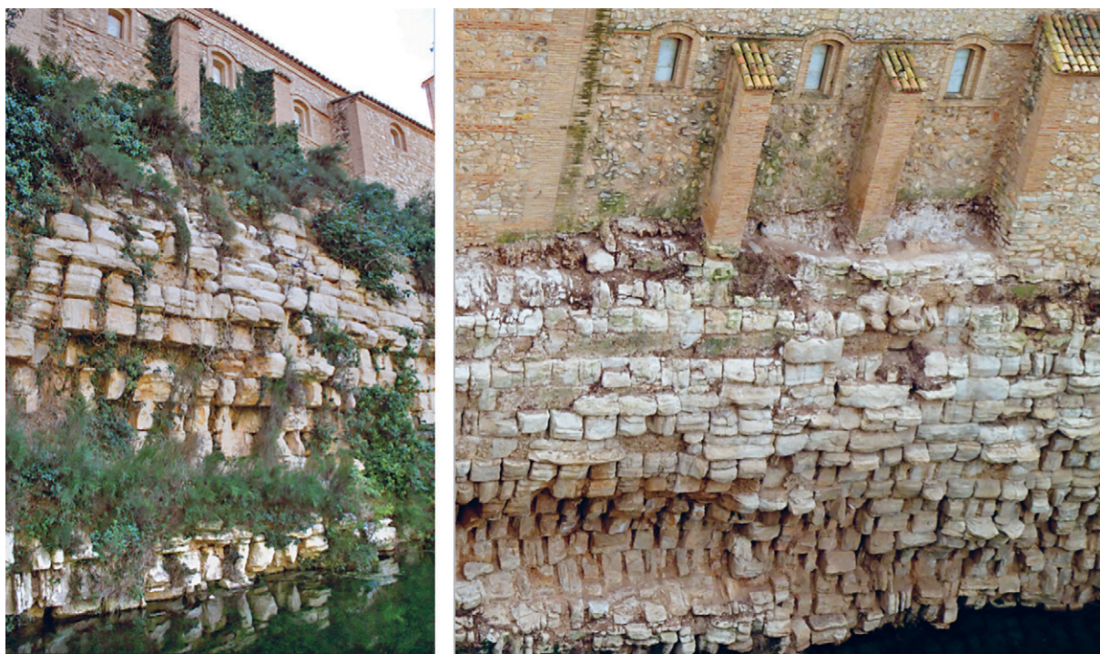
Figura 2. Paramento aguas abajo de la presa de Muel. A la izquierda, estado previo a su limpieza. A la derecha, el mismo paramento en el año 2010, después de eliminar la vegetación.
