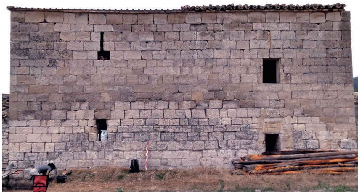
Figura 14. Vista general de la fachada trasera con un arco de humedad por capilaridad.
