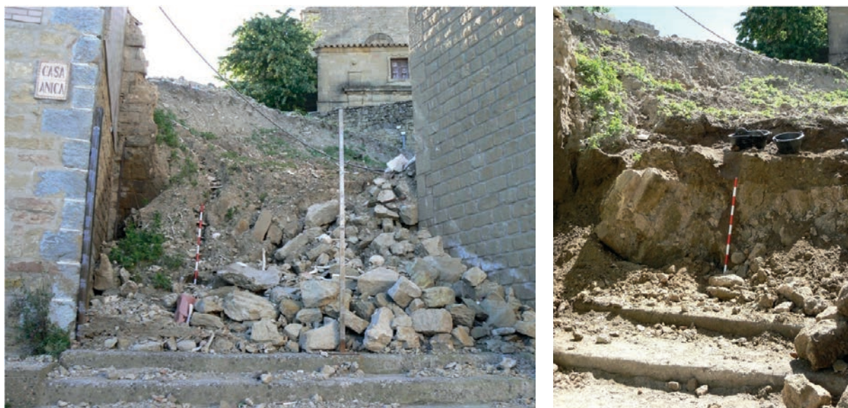
Figura 2. Imagen de la calle La iglesia de acceso al Castillo. A la izquierda totalmente ocupada por el desplome del muro suroeste y el posterior deslizamiento de las tierras del camposanto contenidas. A la derecha, queda a la vista el muro desplomado directamente sobre la escalinata. Vistas desde el oeste.
