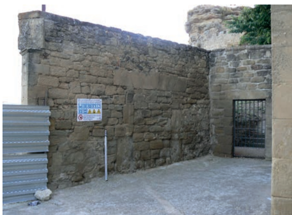
Figura 27. Vista desde el sur del muro sureste ue.38, y de la antigua puerta de acceso al camposanto, clausurada.
